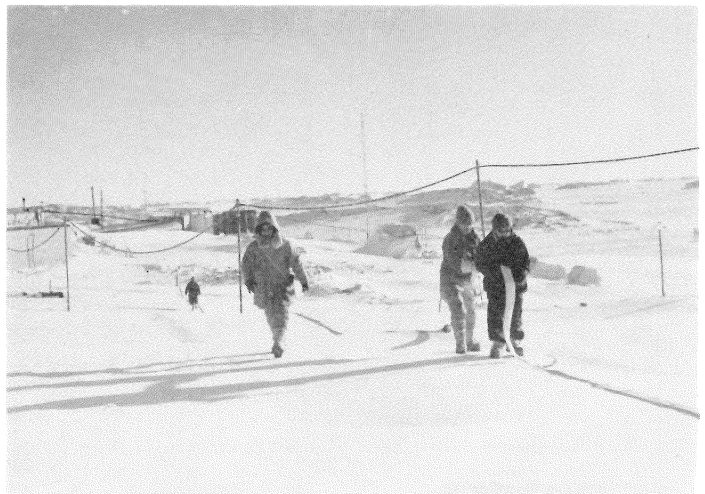
ドリフトをこえて池から130 KL タンクへ水道用に消防ポンプのホース敷設
